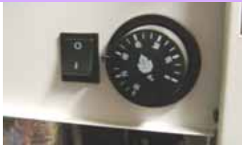
Aquastat de réglage de la température de la chaudière
