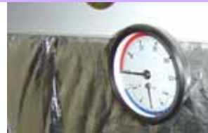
Indicateur de température et pression de la chaudière
