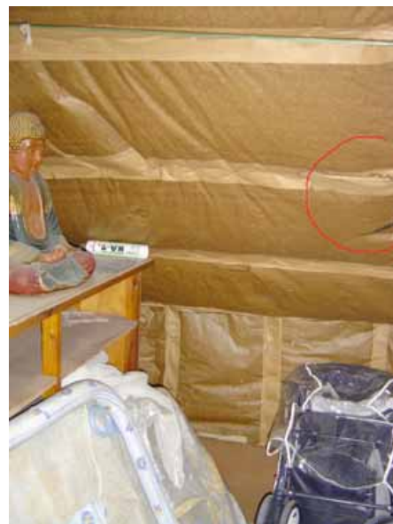
Film pare-vapeur perforé + Épaisseur d'isolant de 6 cm insuffisante
