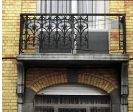
Balcon à garde-corps en fonte dont deux éléments ont été brisés.
