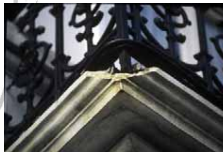
Le gonflement du métal sous l'effet de la rouille, combiné au gel, provoque des cassures dans la pierre.
