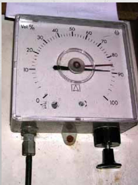
Grâce à une jauge pneumatique , on pourra toujours contrôler le niveau d'eau dans la citerne.
