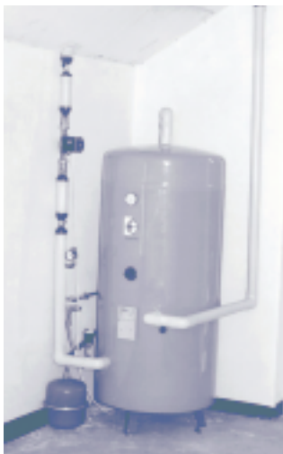
Réservoir de stockage vertical
