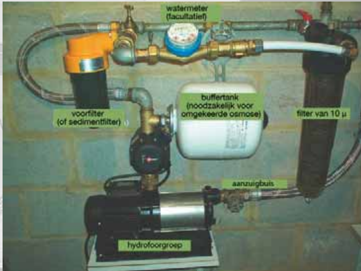
Het water van de regenput wordt dankzij een pomp onder druk gezet (waterpompinstallatie).
