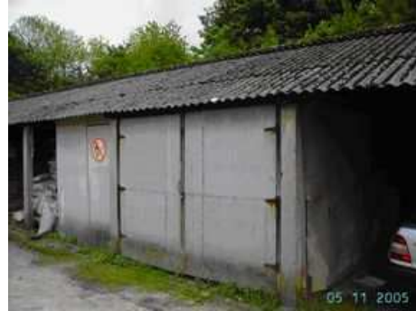
Photo 6 : Double porte et parois en amiante-ciment d'un local de stockage. La toiture est constituée de plaques ondulées en amiante-ciment
