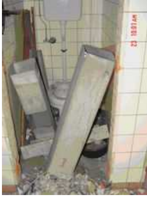
Photo 5 : Gains d'aération en amiante-ciment (dans des sanitaires)
