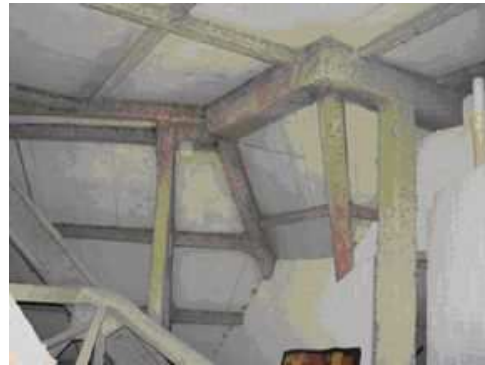
Photo 38 : Flocage d'amosite (non encapsulé) sur des poutres métalliques et plaques d'isolation intérieure de type « Pica »
