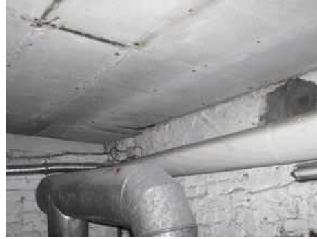
Photo 44 : Plaques de faux-plafond Rf de type « Pical » dans une chaufferie (gaufnage caractéristique)
