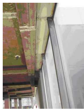
Photo 42 : Plaques de type « Pical » pare-flammes fermant l'espace entre la dalle en béton et la façade (photo dans un immeuble de bureaux)
