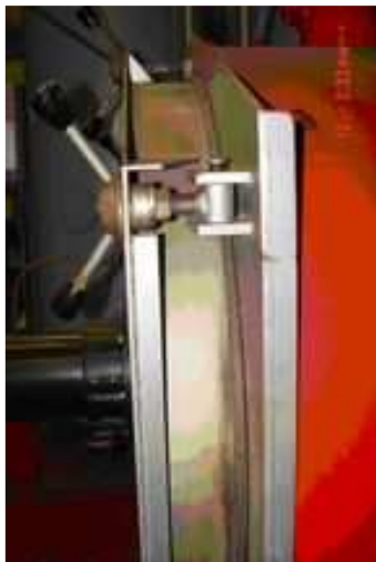
Photo 23 :Corde sur la porte d'une chaudière
