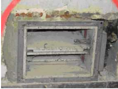
Photo 43 : Clapet coupe-feu bardé intérieurement de plaques de type « Pical ». La lame de fermeture est elle-même constituée de plaques de type « Pical »
