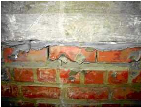
Photo 35 : Joint de dilatation en mousse contenant des fibres d'amiante bleu (à la rencontre entre le haut d'un mur et le plafond en béton)
