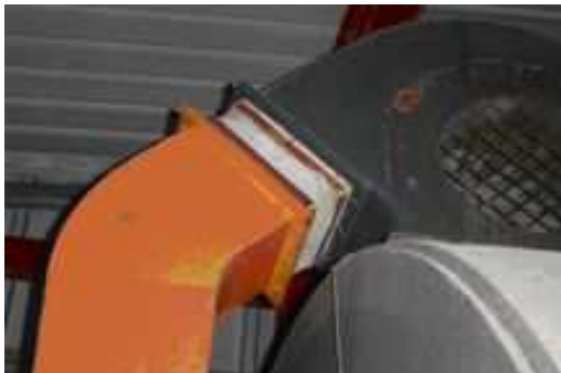
Photo 19 : Soufflet anti-vibratoire à la jonction entre gaine de ventilation et moteur
