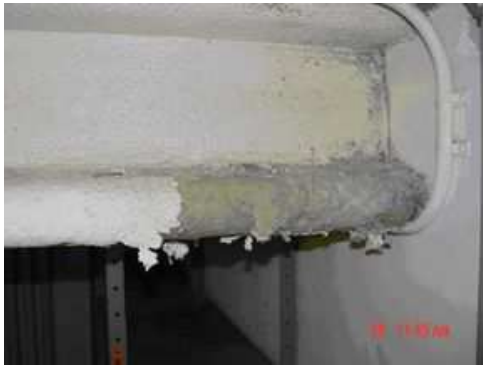
Photo 37 : Flocage d'amosite (gris) avec sa couche extérieure d'encapsulation (peinture épaisse) sur une poutre métallique en forme de « I ». On remarquera la surface extérieure plissée
