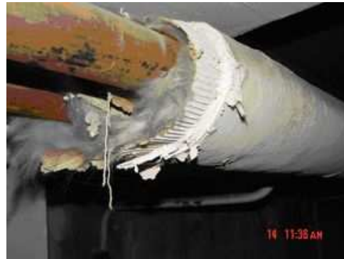
Photo 28 : Calorifuge : les fibres d'amiante sont localisées dans la couche de plâtre extérieure
