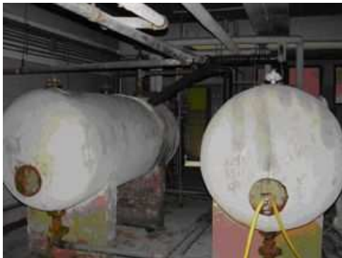
Photo 29 : Réserves d'eau chaude enrobées de plâtre amianté
