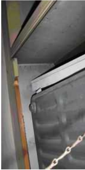
Photo 17 :Carton d'amiante (surface légèrement plissée) dans un habillage autour d'un radiateur
