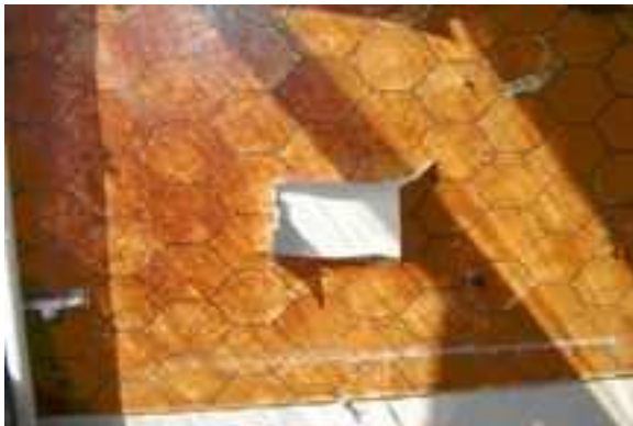
Photo 13 : Balatum au motif assez caractéristique, dont la sous-couche cartonnée contient des fibres d'amiante faiblement liées
