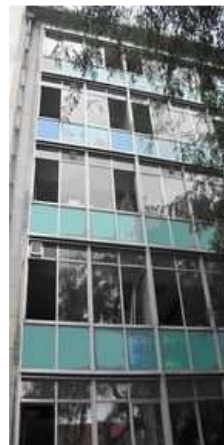
Photo 10 : Panneaux en amiante-ciment de type « Glasal » en allège sur une façade (couche de finition extérieure bleu-vert)
