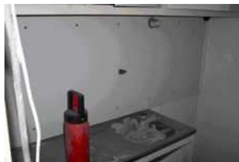
Photo 8 : Panneau décoratif en amiante-ciment de type « Glasal » (couche de finition extérieure bleue) dans une cuisine
