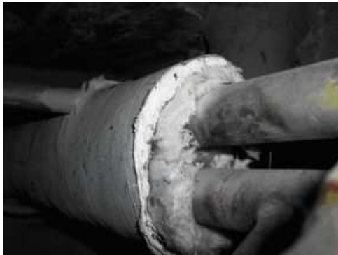
Photo 27 : Calorifuge : les fibres d'amiante se trouvent dans la fine couche de plâtre périphérique
