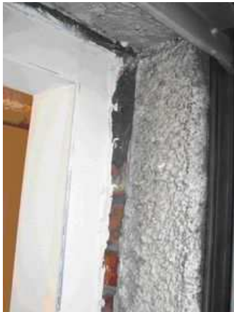
Photo 33 : Crépi mural extérieur amianté
