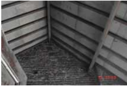
Photo 11 : Fines plaques de sous-toiture de type « Menuiserie » (ici rosâtre, mais souvent jaunâtre)
