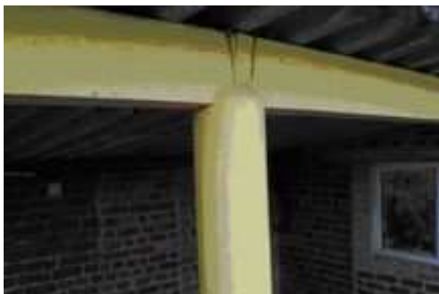
Photo 9 : Tuyau en amiante-ciment utilisé comme coffrage perdu pour constituer le pilier de soutien d'un préau. Le gaufage extérieur est caractéristique.
