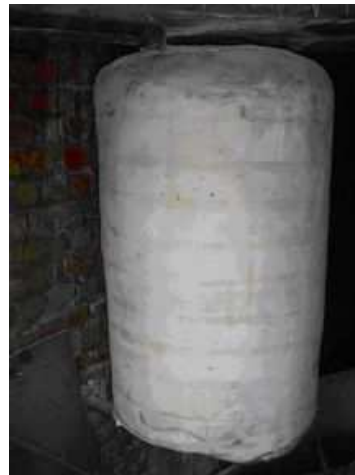
Photo 30 : Vase d'exposition calorifugé avec du plâtre amianté
