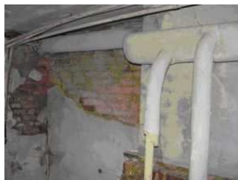
Photo 32 : Vieux calorifuge monocouche en terre à diatomées chargée en fibres d'amiante
