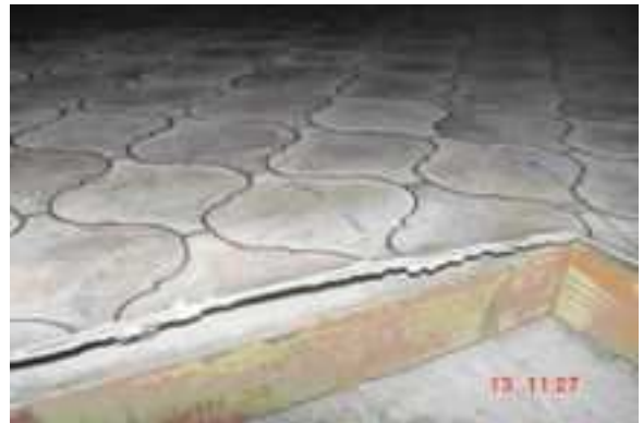
Photo 14 : Balatum au motif assez caractéristique, dont la sous-couche cartonnée contient des fibres d'amiante faiblement liées
