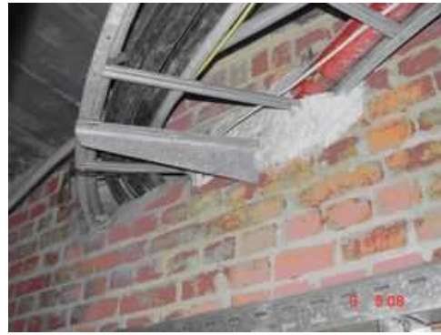
Photo 40 : Bourre d'amiante là où des câbles électriques traversent un mur
