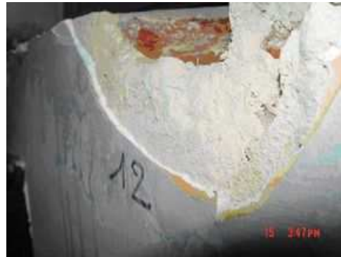
Photo 34 : Fine couche de finition murale en plâtre contenant des fibres d'amiante
