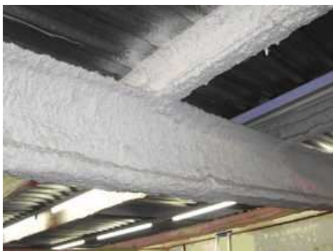
Photo 36 : Plâtre dur amianté projeté sur des poutres métalliques de structure
