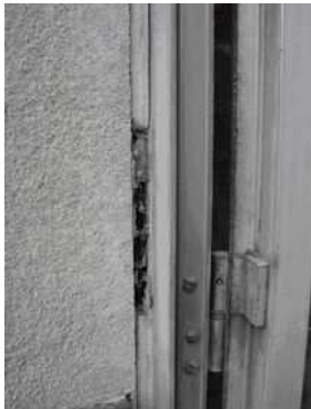
Photo 39 : Mastic vitrier amianté pour l'étanchéité autour d'un châssis de fenêtre
