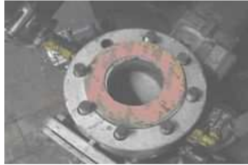
Photo 18 : Joint amianté de type « Klingérit » entre les brides de conduites de chauffage
