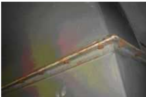
Photo 21 : Cordelette au niveau de la bride entre deux éléments de gaine de ventilation
